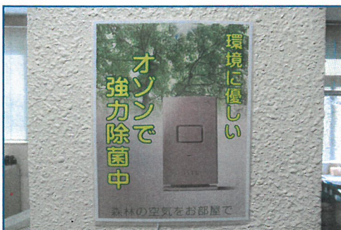
ロビー、各教室はオゾン発生器を設置
